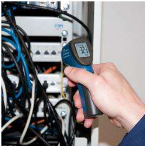
Midiendo la temperatura con el termómetro sin contacto en un armario de distribución.
